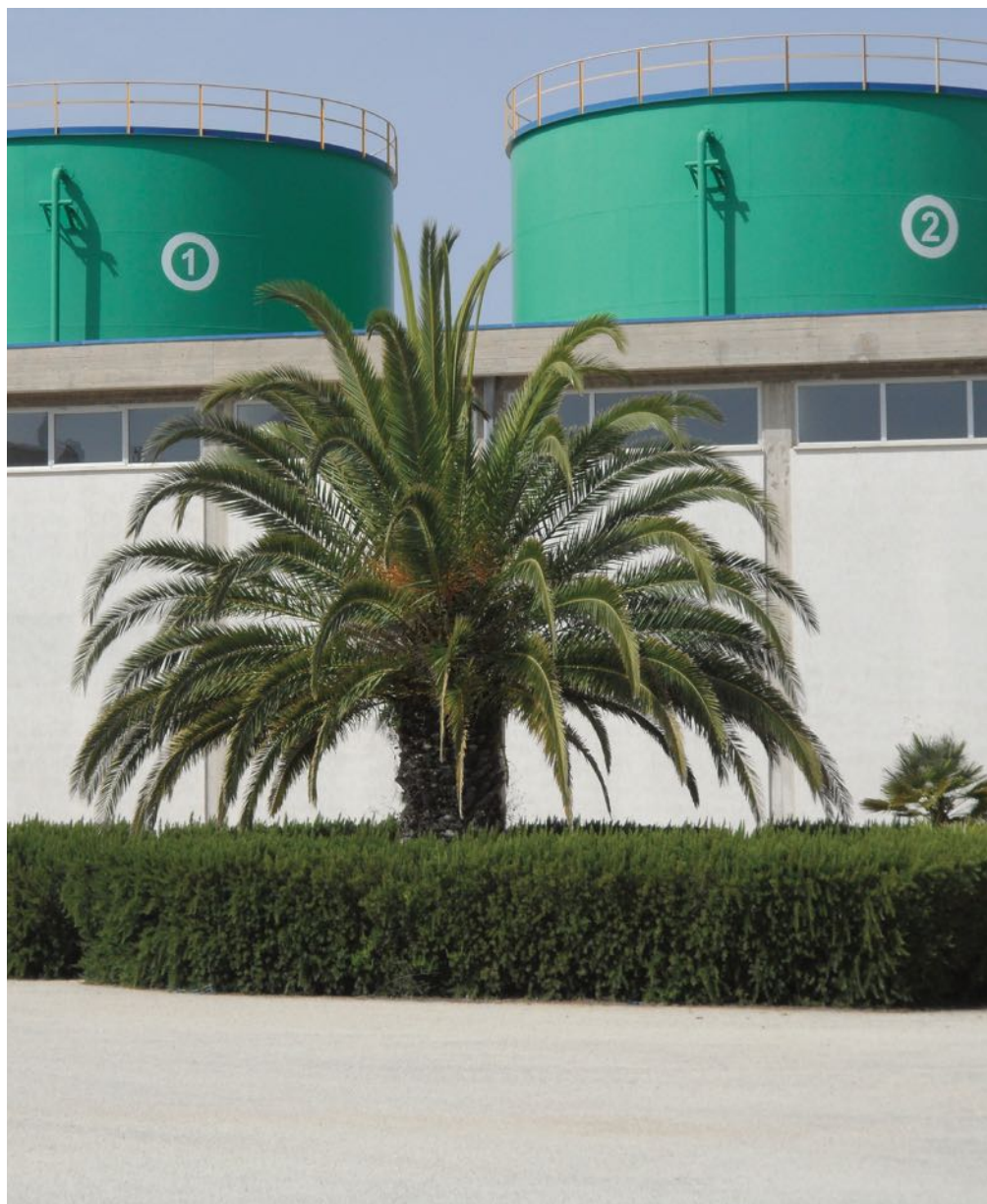
Edificio pompe antincendio e serbatoi acqua antincendio
