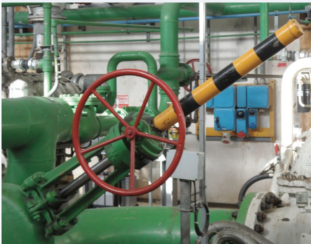
Valvola intercettazione tubazione antincendio
