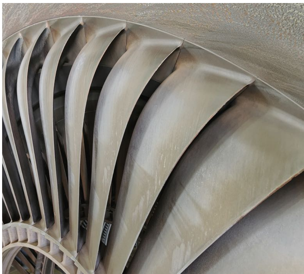
Particolare palette fisse turbina a vapore
