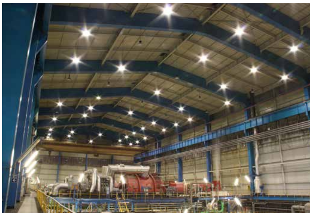
Sala macchine della Centrale
